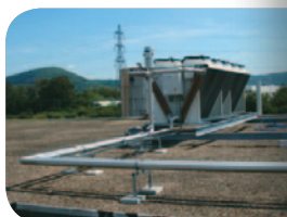
Dry Cooler en toiture
